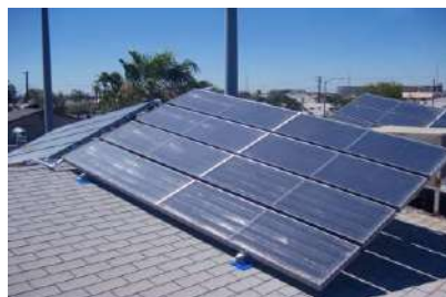
Fig. 5 Solar Thermal Collectors
